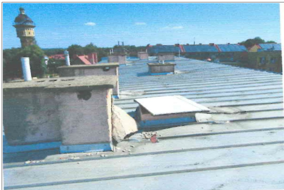
Fotografie obrazujące stan kominów.
