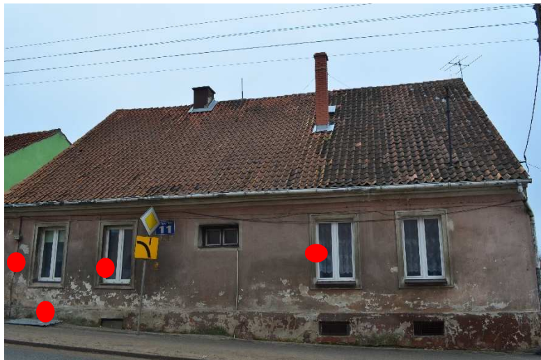
Fot.4. Gołdap- kamienica przy ul. Mazurskiej 11 elewacja frontowa- miejsca pobrania próbek. Fot. B. Kwasiborska
