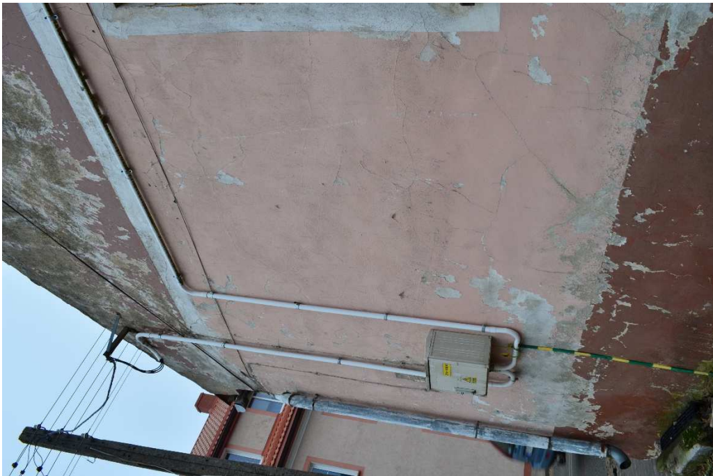
Fot.20. Gołdap- kamienica przy ul. Mazurskiej 11– elewacja boczna, zbliżenie- stan obecny. Fot. B. Kwasiborska
