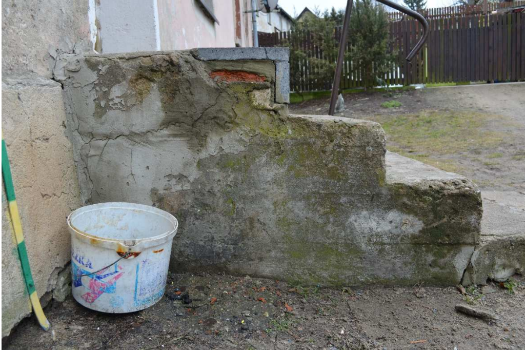
Fot.13. Gołdap- kamienica przy ul. Mazurskiej 11– elewacja tylna- schody, zbliżenie- stan obecny. Fot. B. Kwasiborska
