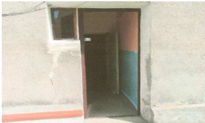
Fotografie obrazujące spękane ściany konstrukcyjne budynku WM Górna 15
