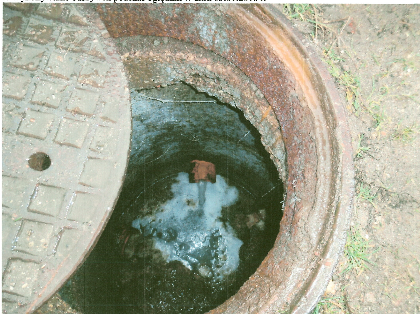
8. Studzienka przykanalika sanitarnego.
