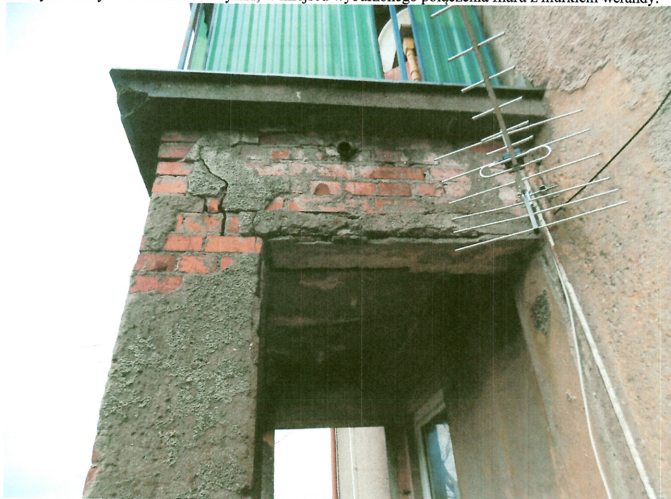
24. Wyplukane spoiny, luźne cegły w murze. Braki i odspojenia tynku.
