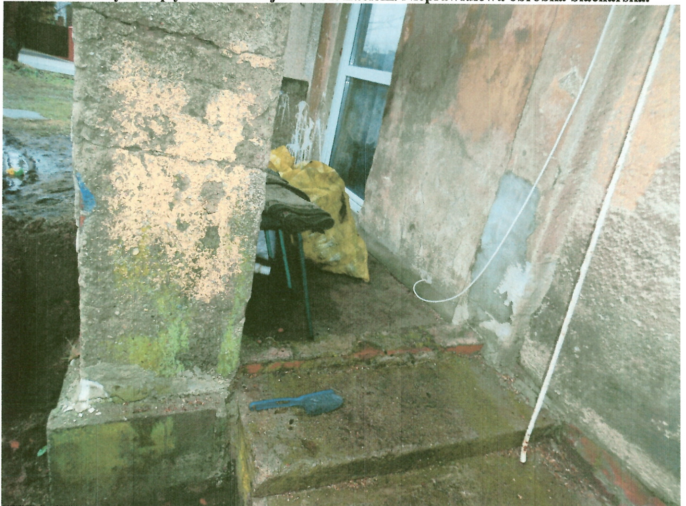
16. Wykonane dwa stopnie schodów w wejściu na werandę. Zatynkowane miejsce po wyburzeniu murku.
