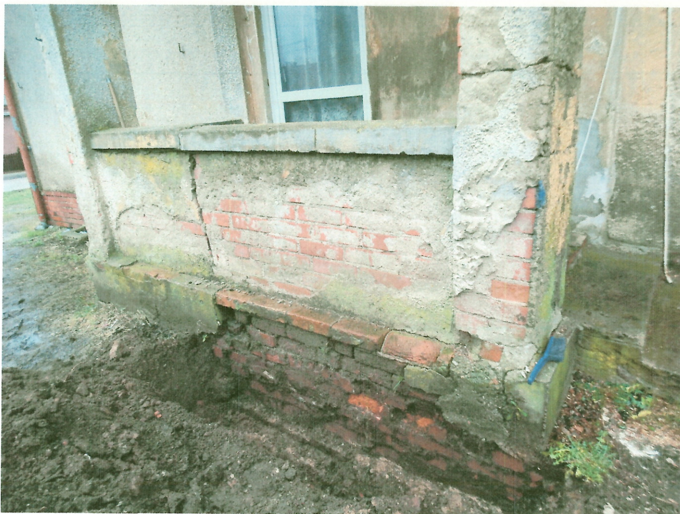
3. Wykonana odkrywka w gruncie, widoczna ława i ściana fundamentowa. Uszkodzenia muru ceglanego.
