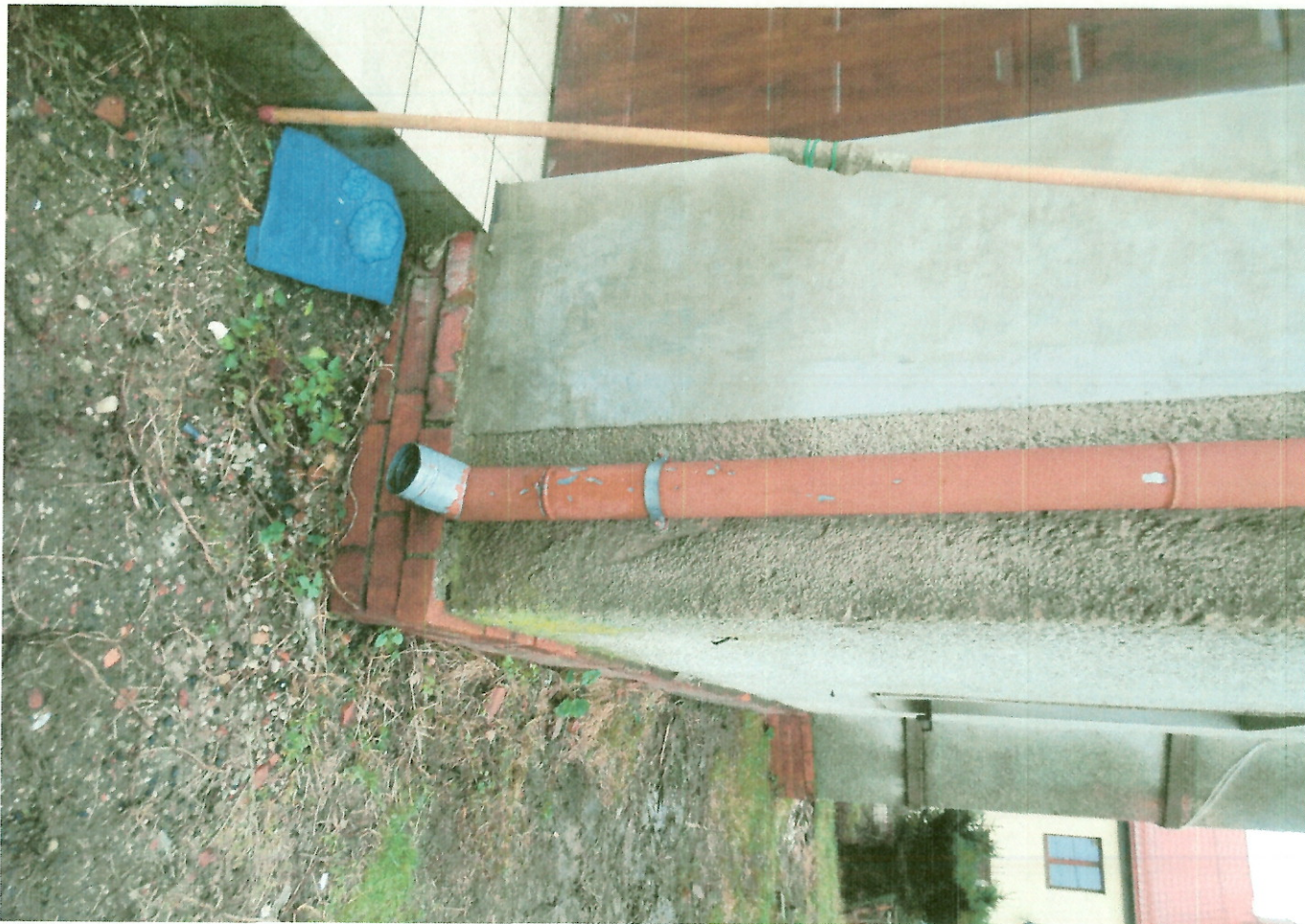
27. Spadek terenu w stronę budynku. Brak odprowadzenia wód opadowych.
