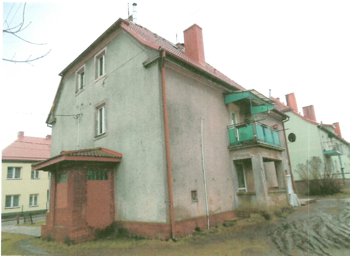
Budynek Wspólnoty Mieszkaniowej w Gołdapi Kościuszki 5. Widok na ganek z balkonem usytuowany przy budynku od strony podwórka.
