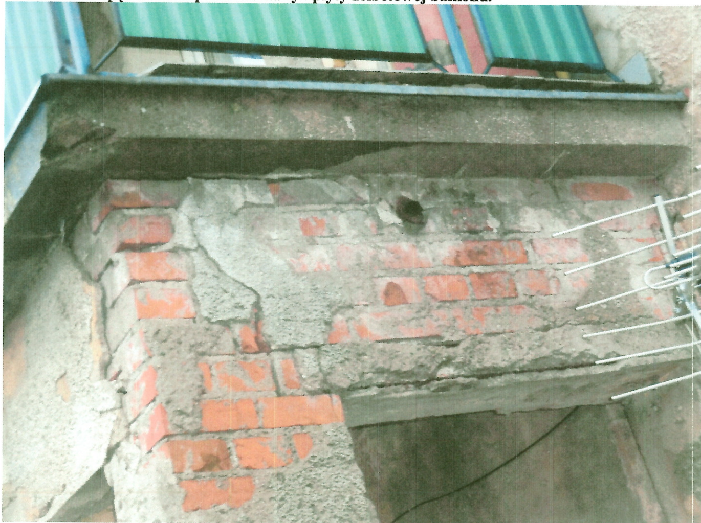
14. Widoczne zacieki na płycie balkonowej i wypłukane wypełnienia spoin między ceglami.
