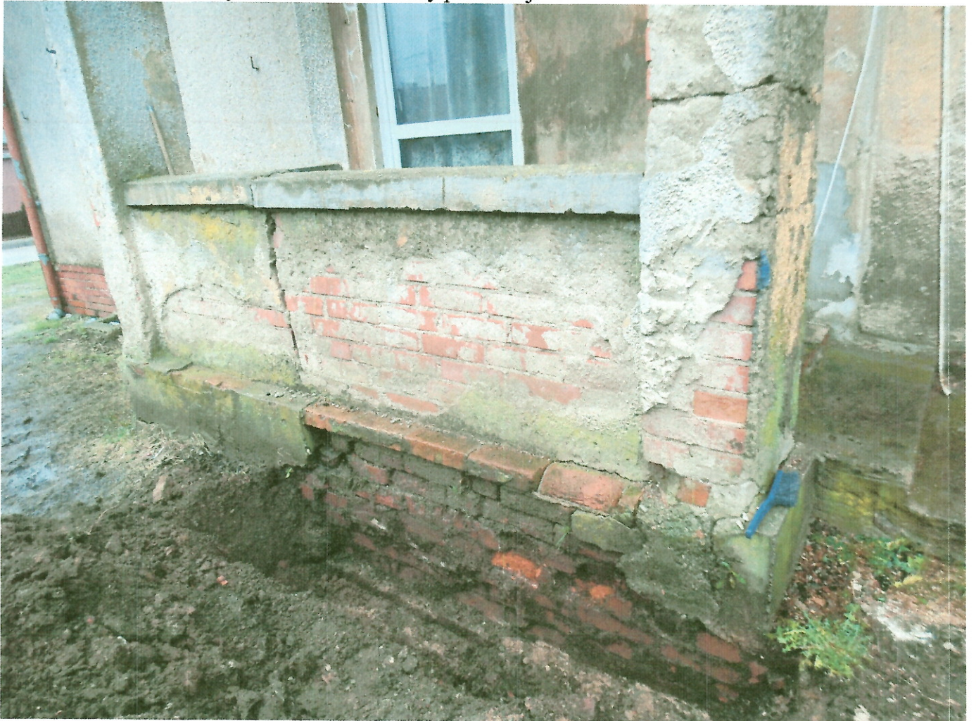
10. Pęknięty filar i murek werandy.
