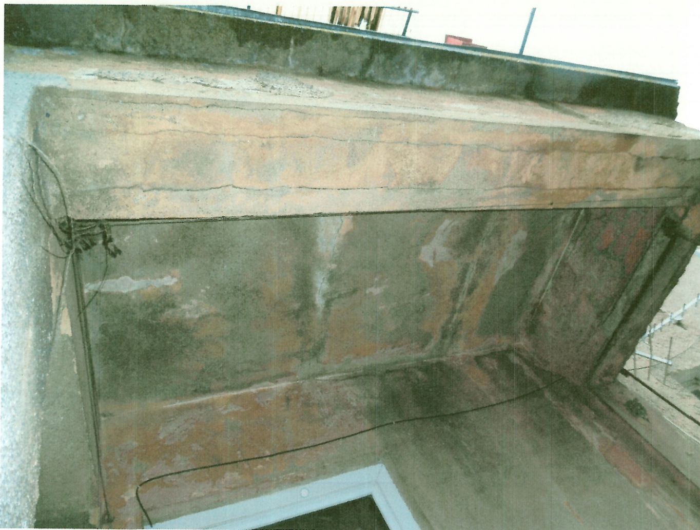
13. Widoczne spękania nadproża werandy i płyty żelbetowej balkonu.
