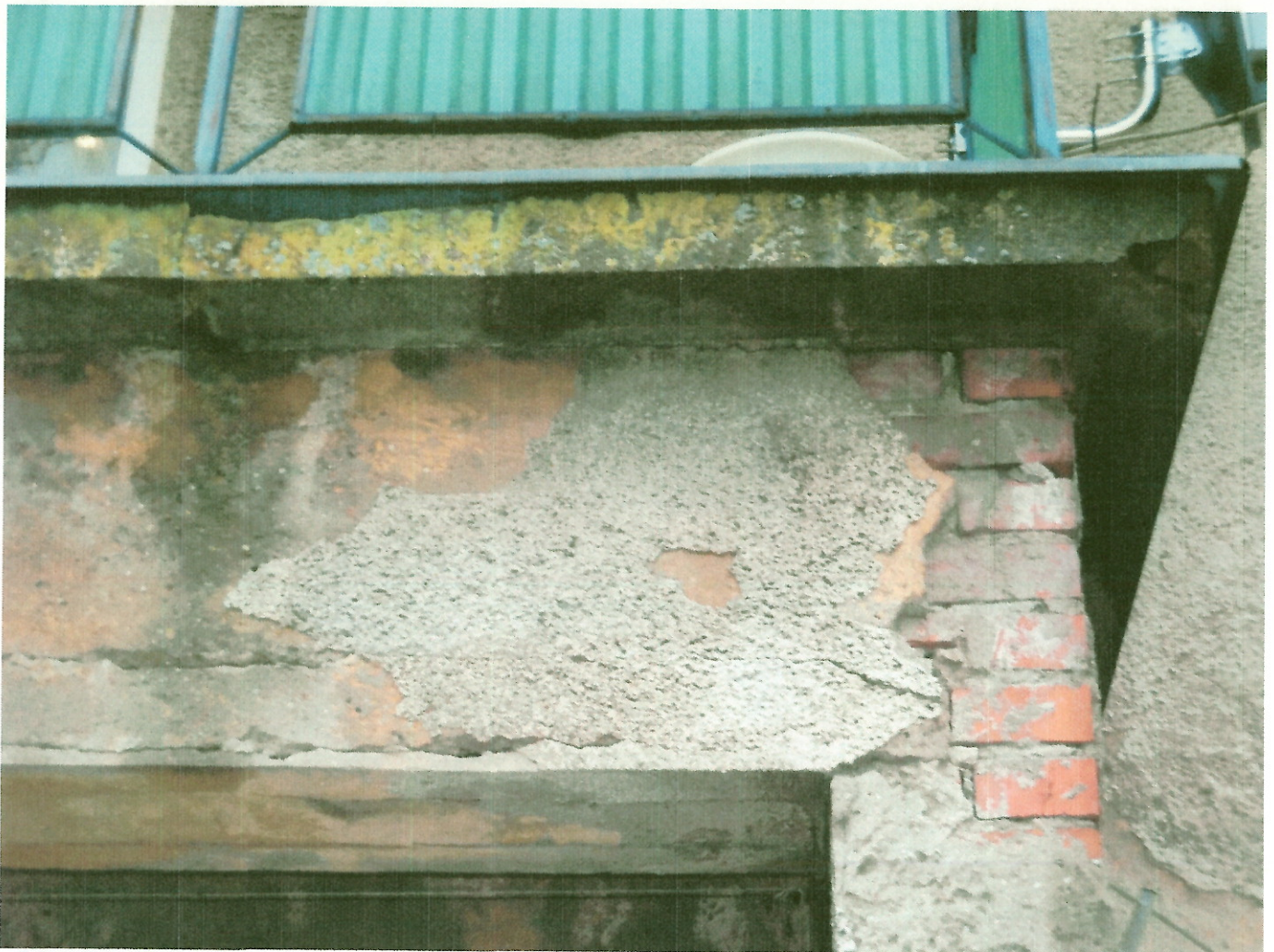
15. Widoczne ubytki w płycie żelbetowej balkonu. Zacieki. Nieprawidłowa obróbka blacharska.
