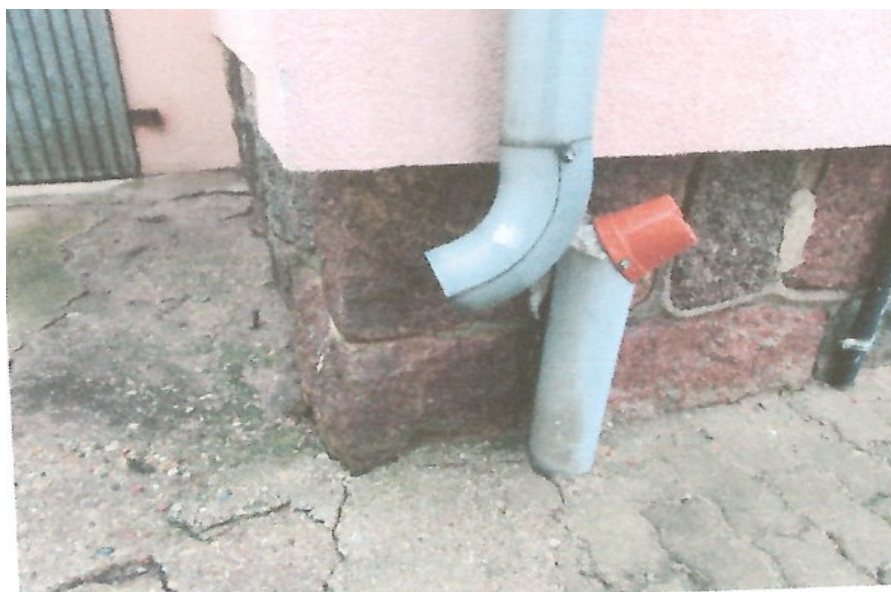
Fotografia obrazująca obecną rurę spustową.
